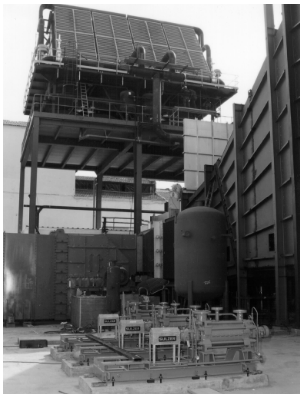
Fig.1. Aerocondensadores sobre una turbina de gas
